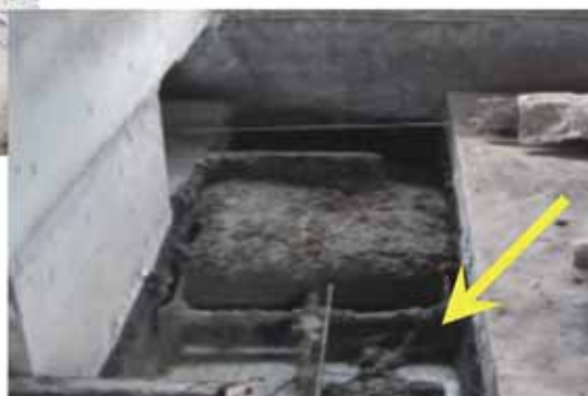
牽引量を超過している状態
