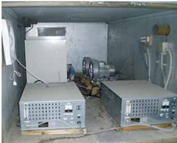
オゾン発生装置
