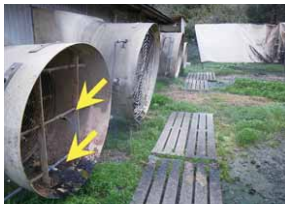
除塵装置（矢印：水の噴霧ノズル）
