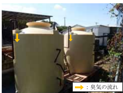
写真 3 臭気捕集タンクの入気側
