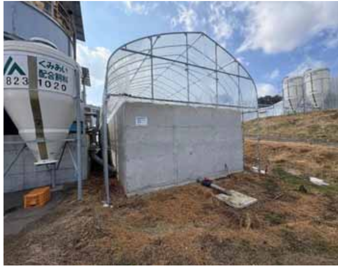
写真2 軽石脱臭槽外観
