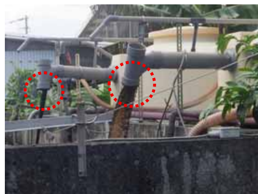
写真 8 立上り管から活性汚泥が越流
