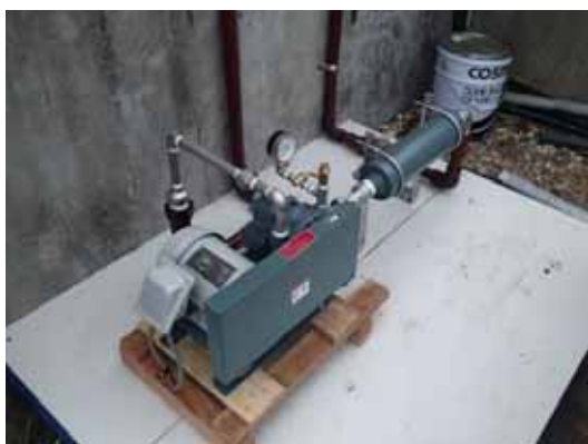
写真 7 脱臭用ブロワ
