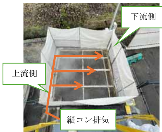
写真 2 脱臭装置上部からの様子 (脱臭装置周辺をメッシュで覆っている)
