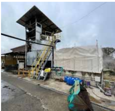
写真 1 密閉縦型堆肥化装置と水洗脱臭装置
