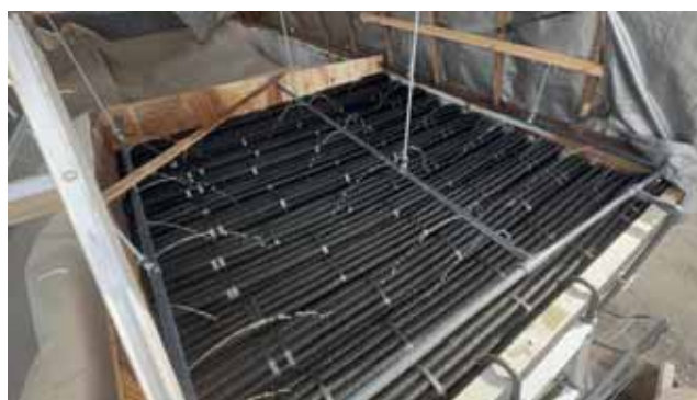
写真1 新たな接触濾材を組み込んだ脱臭槽の外観
