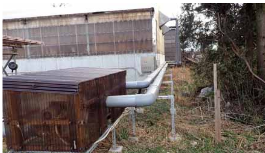
写真3 堆肥舎から水洗脱臭装置への排気ルート (送風ブロワ (2.2kW×2台) で吸引し、水洗脱臭槽内へ送風する)
