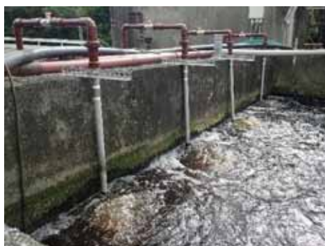
写真 1 既存の放流槽で脱臭
