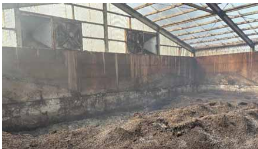
写真2 堆肥舎からの排気の引込口（堆肥舎内）
