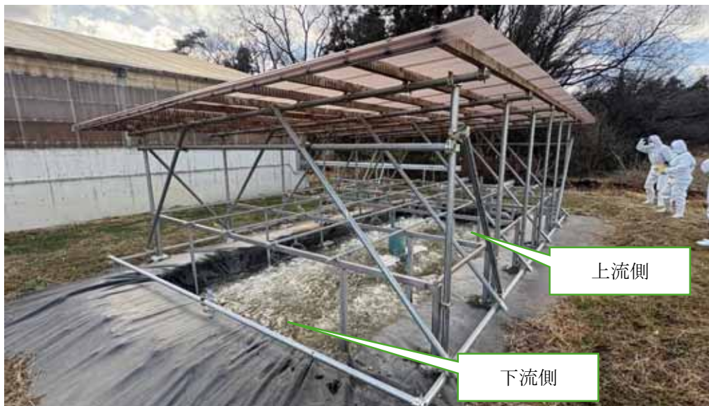
写真1 水洗脱臭装置外観
