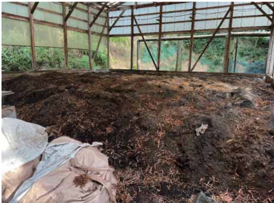
写真3 土壌脱臭槽の様子
