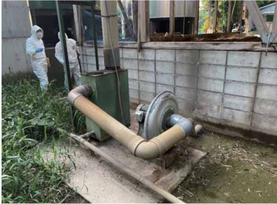
写真2 送風ブロワー (3.7kW)
