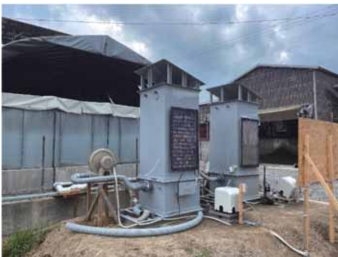
写真1 スクラバー装置の外観
