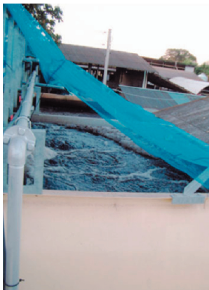
ばっ気槽上部
