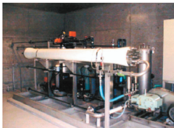
逆浸透 (RO) 膜ユニット
