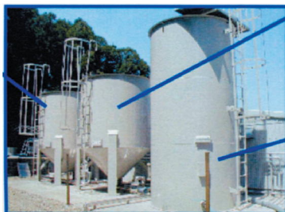
最初沈殿槽、最終沈殿槽
