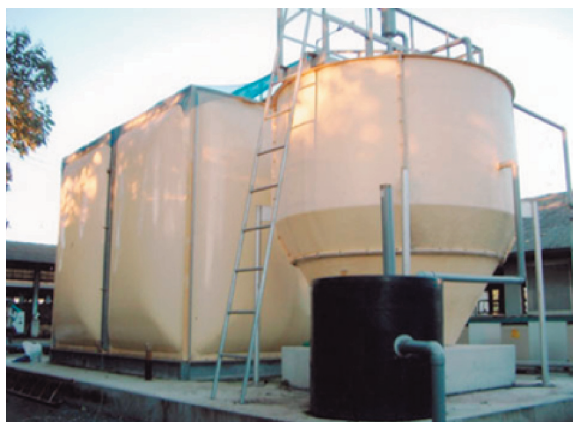
施設全景 (2) 手前より消毒、沈殿、ばっ気槽
