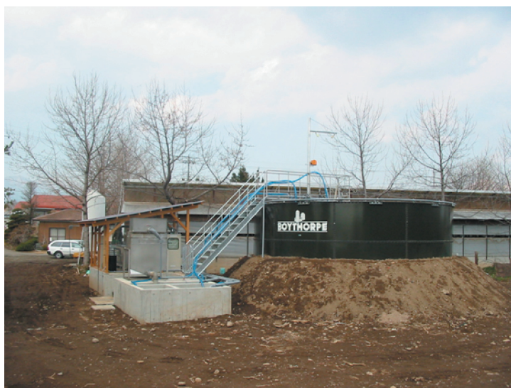
施設全体 円形バッキ槽(右) 調整槽、汚泥槽、処理水槽 (左コンクリート槽)
