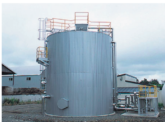
メタン発酵槽
