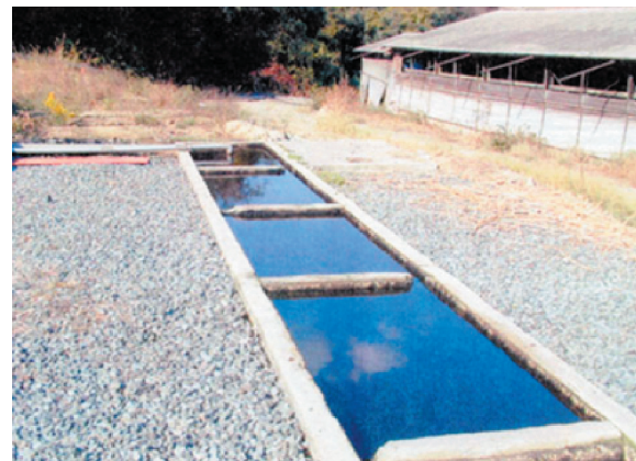
流水型生物ろ過槽
