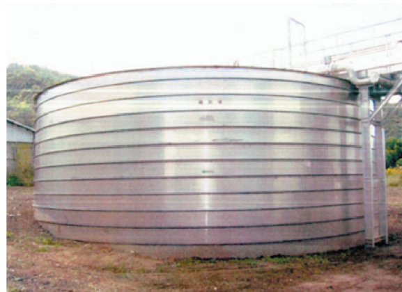
ばっ気槽外観
