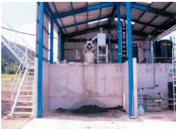
固液分離機 (2) 下部は分離水槽
