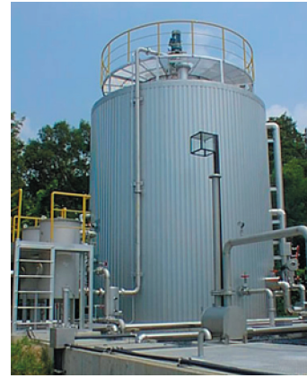
メタン発酵槽
