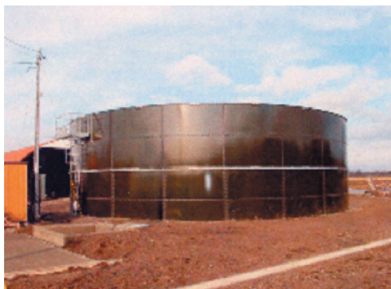
消化脱離液貯留槽
