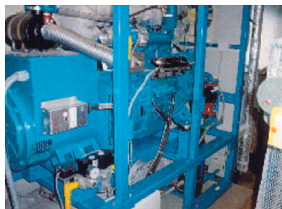
ガスエンジン発電機
