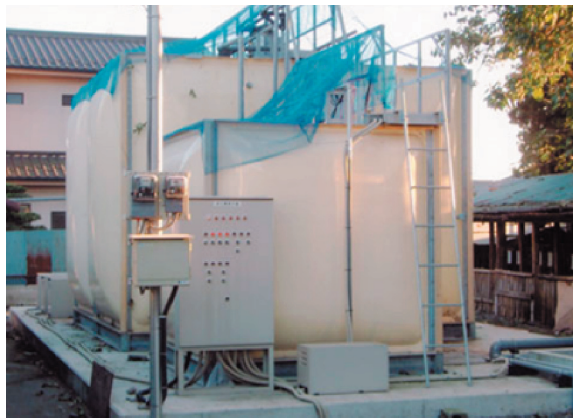
施設全景 (1) 手前より操作盤、貯留槽、ばっ気槽
