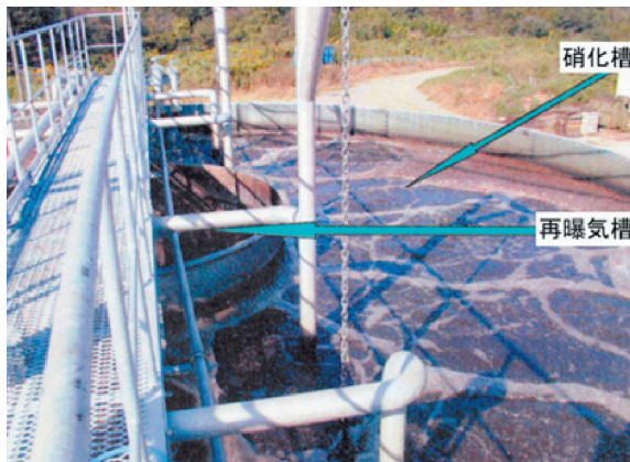
硝化槽（外周）および再ばっ気槽（中心）
