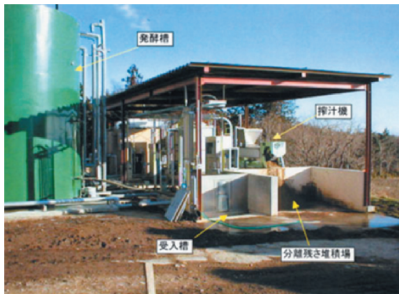
受け入れ・固液分離設備
