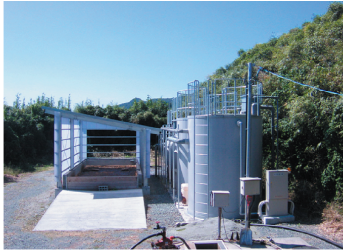
ばっ気ろ床槽、沈殿槽（右）、汚泥濾床（左）
