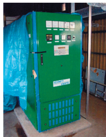
ガスエンジン発電機
