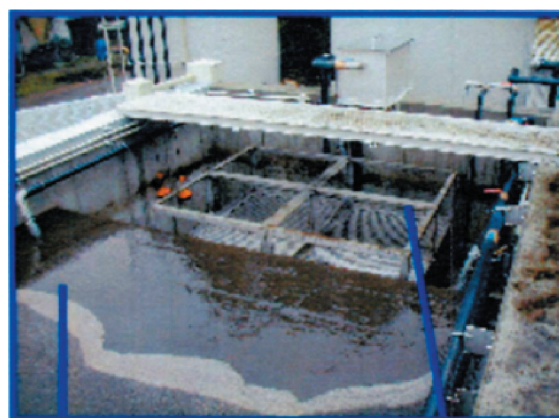
硝化・脱窒素槽
