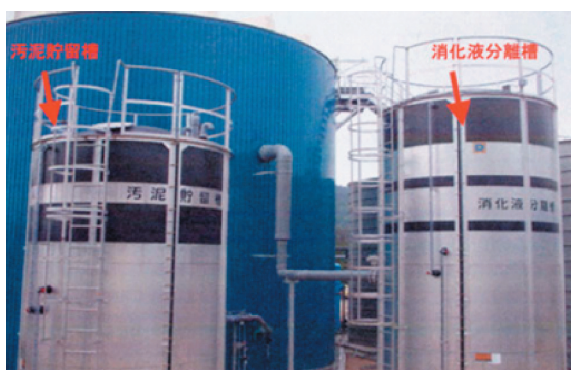
メタン発酵槽 (1)
