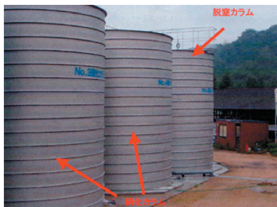
消化脱離液浄化設備 (2)
