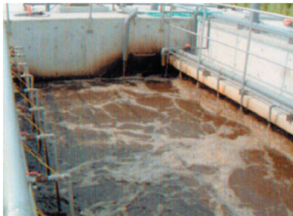
ばっ気槽 (硝化槽)
