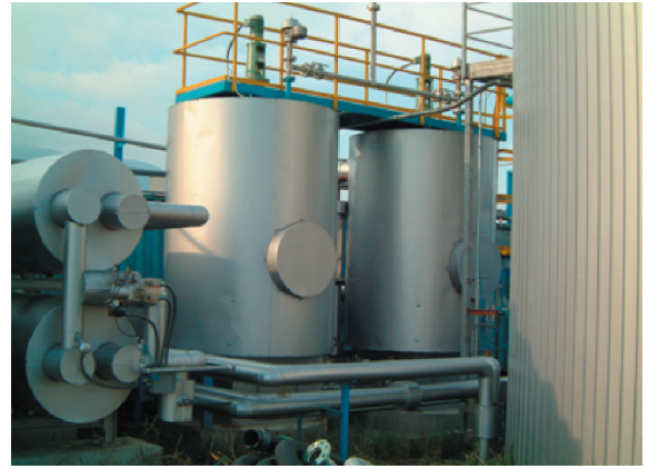
消化槽 (メタン発酵槽)
