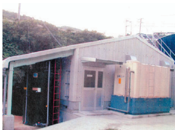
ブロー室、制御室、薬品室
