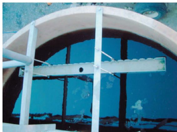
沈殿槽越流せき
