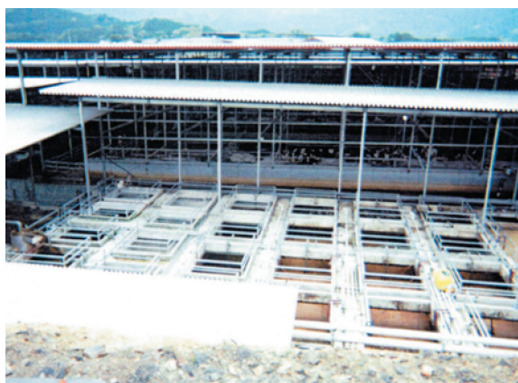
浄化槽全景 (縦方向に2マスづつばっ気と膜分離槽として使用) 現在、膜分離槽は右側より三系統稼働中
