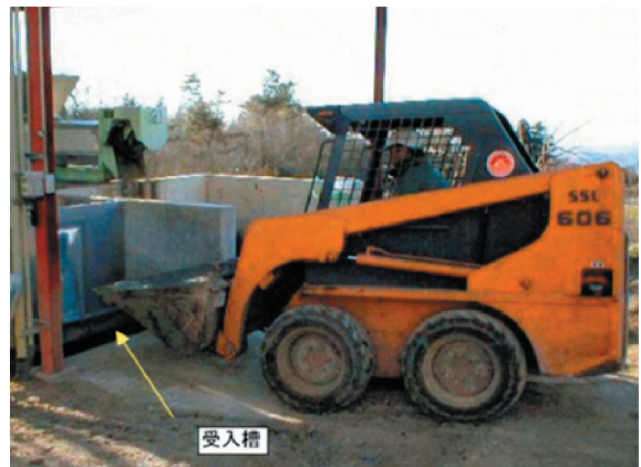
受け入れ槽ふん投入
