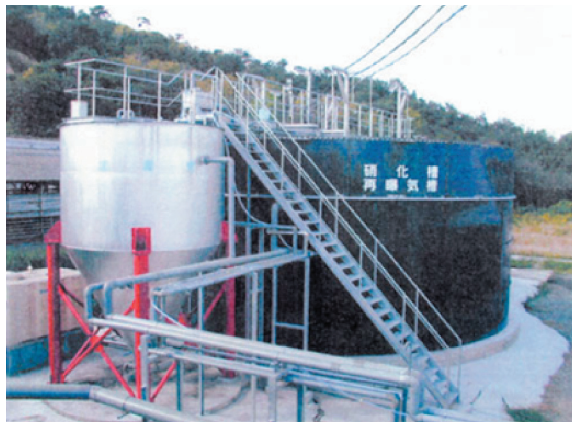
右：硝化槽、再ばっ気槽、左：沈殿槽
