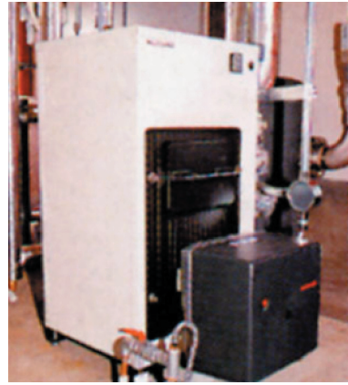
ガスボイラー
