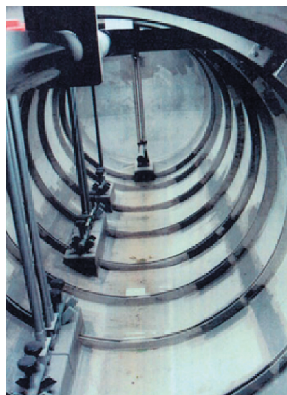
水中攪拌ポンプ(奥)、散気管(手前)
