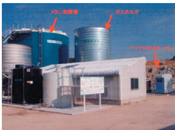
メタン発酵槽 (2)
