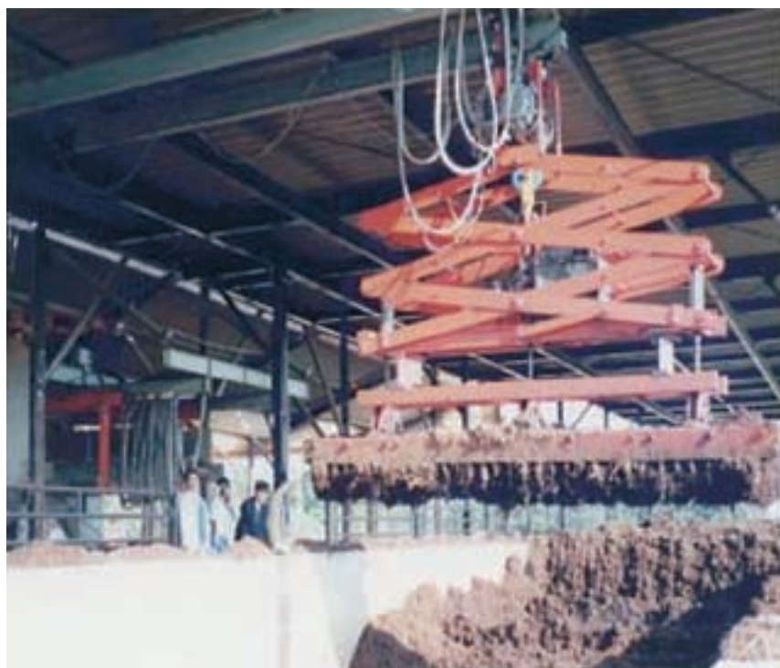
図 2 - 17 堆肥クレーン
