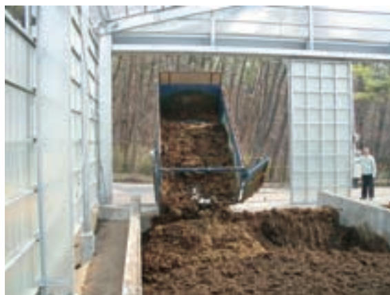
1次処理槽投入口 (トラックによる投入)
