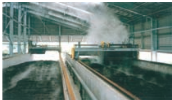
発酵槽および攪拌装置
