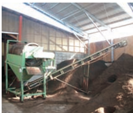
堆肥分別機 (袋詰め用のみ分別する)
