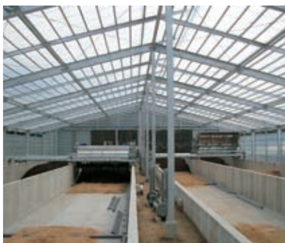
1次処理槽 (幅5m×長さ65m×深さ1.5m×4レーン)
