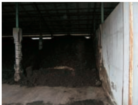
原料貯槽（混合兼用）
