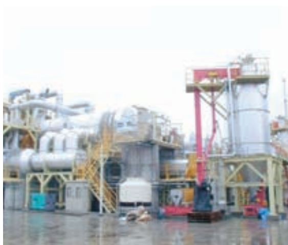
炭化・活性炭化処理設備
