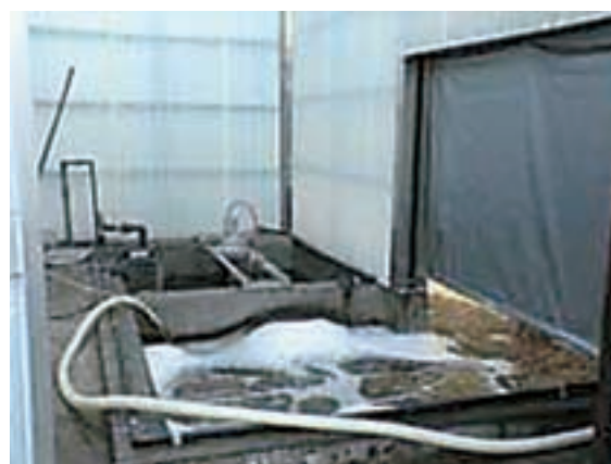
水洗式脱臭の水処理設備
