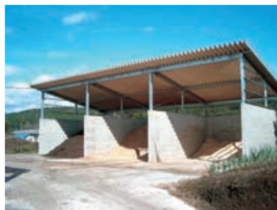
おが屑・堆肥貯留槽
