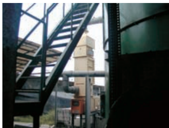
水洗脱臭装置
